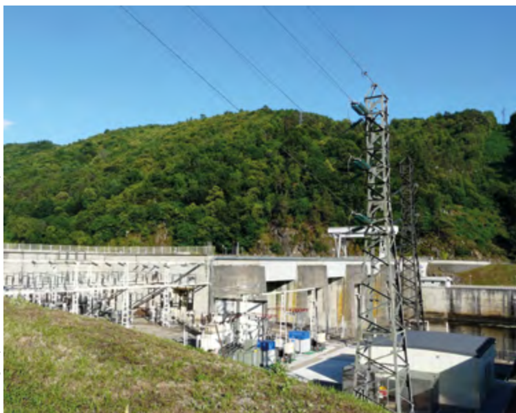
Le poste de transformation électrique du barrage d'Argentat (Corrèze, France).
